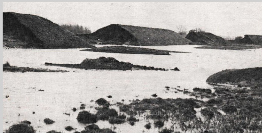
Das Profil des zerstörten Deichkörpers
